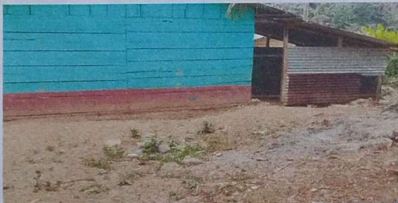
Foto 3: Se observa el deterioro de la estructura de la cocina.
