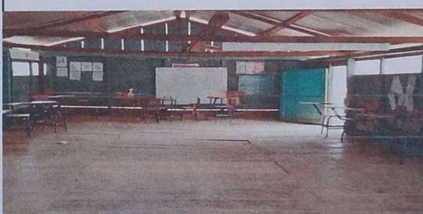
Foto 4: Se observa el deterioro del piso del aula.
