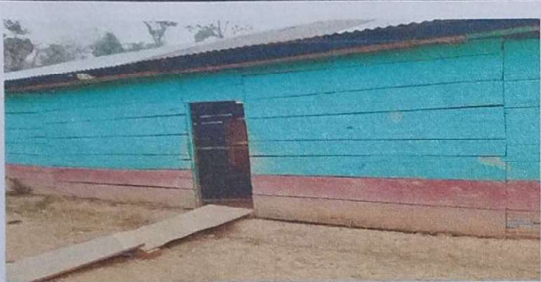
Foto1: Se observa el deterioro de la estructura del techo.
