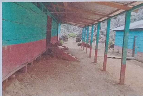
Foto 2: Se observa la falta de piso.
